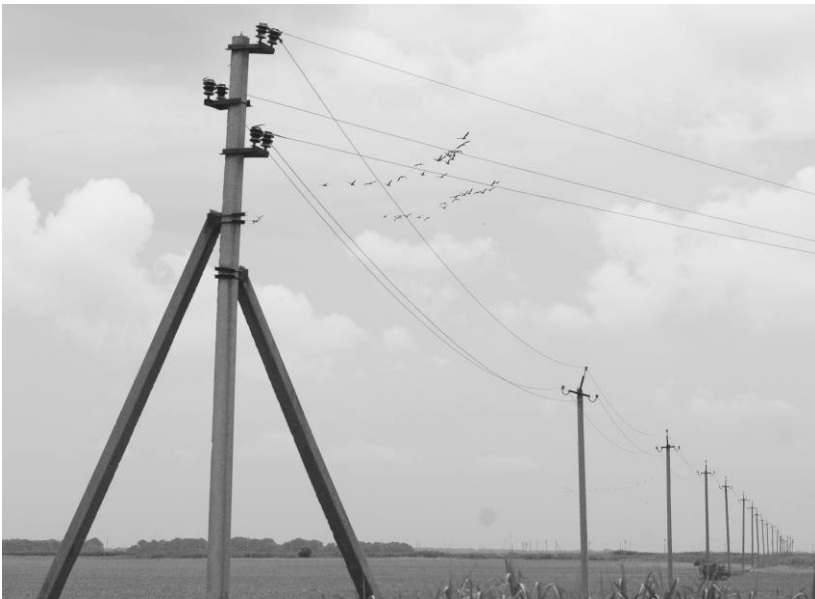
Рисунок 1. Опоры ВЛ 6-10 кВ в открытой местности (сельхозугодья).
