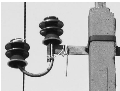
Рисунок 5. Дополнительный «холостой» изолятор ШФ-20 на конце металлической траверсы.
