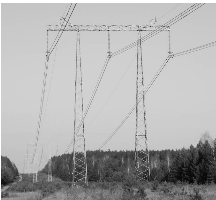
Рисунок 9. Опора и трасса ВЛ-500 кВ в лесной зоне.
