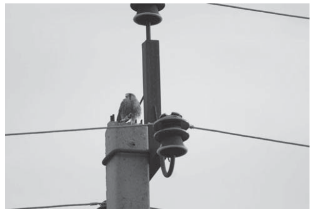
Рис. 8. Обыкновенная пустельга на птицепасной опоре ВЛ 6—10 кВ
