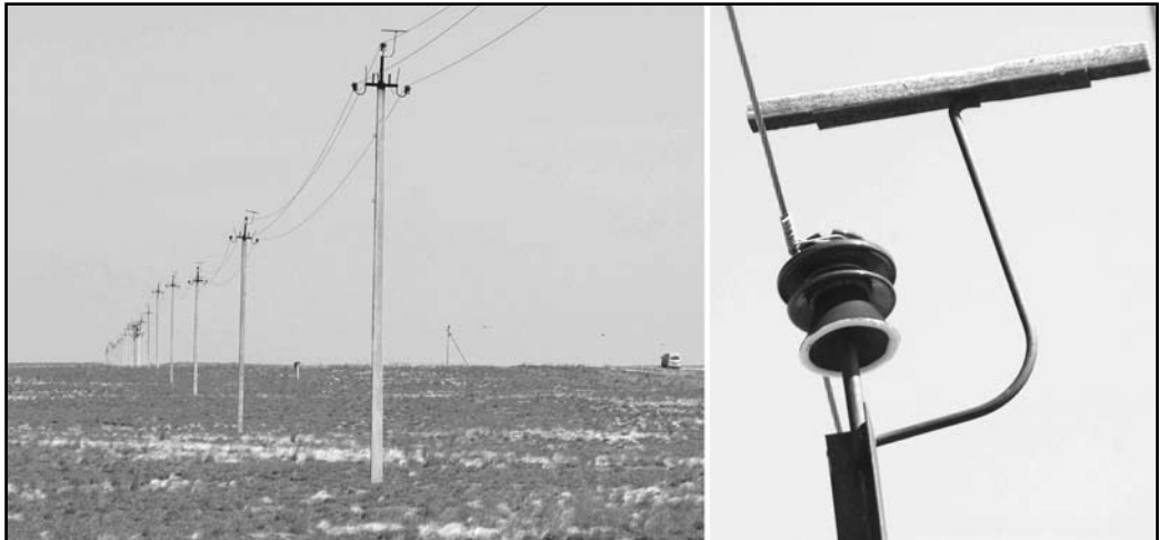
Птицеопасная ВЛ 6–10 кВ на территории Черноземельского района Республики Калмыкия. Использование неизолированных металлических предметов в качестве защитных элементов запрещено действующим законодательством. Фото А. Машыны.
